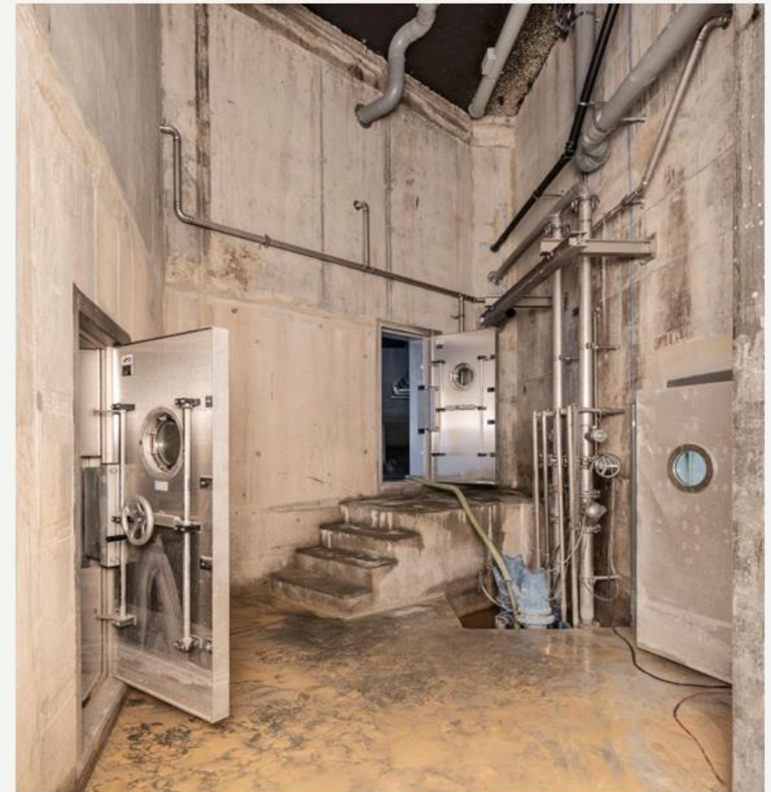
Bereits umgesetztes Projekt: Regenrückhaltebecken im ehemaligen Kino Rex (Foto: Stadt St. Gallen)
